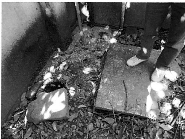
EEEM Pe. Benjamin Copetti – rede de esgoto com defeito.
