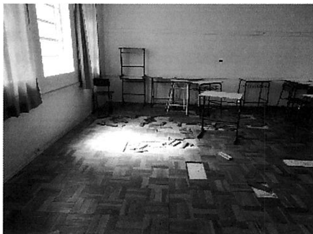
EEEM Pe. Benjamin Copetti – Defeitos no piso de sala de aula interditada.
