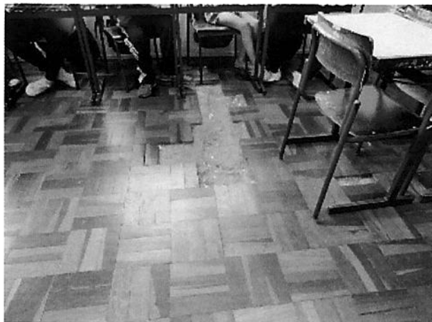
EEEM Pe. Benjamin Copetti – Defeitos no piso de sala de aula em utilização.
