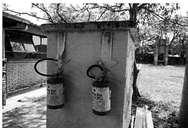
EEEB Padre Rômulo Zanchi – Extintores.
