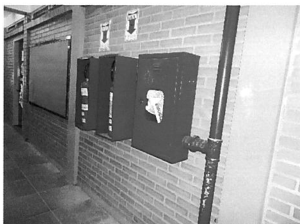
Escola Técnica Estadual Portão – Caixa dos extintores de incêndio sem vidro de proteção.
