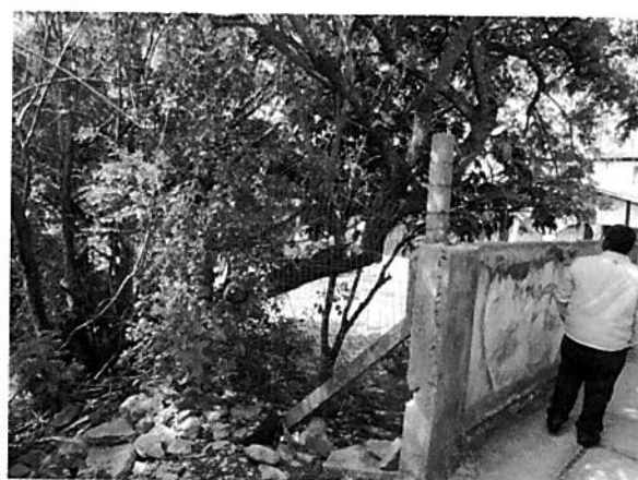
EEEB Padre Rômulo Zanchi – Cerca danificada
