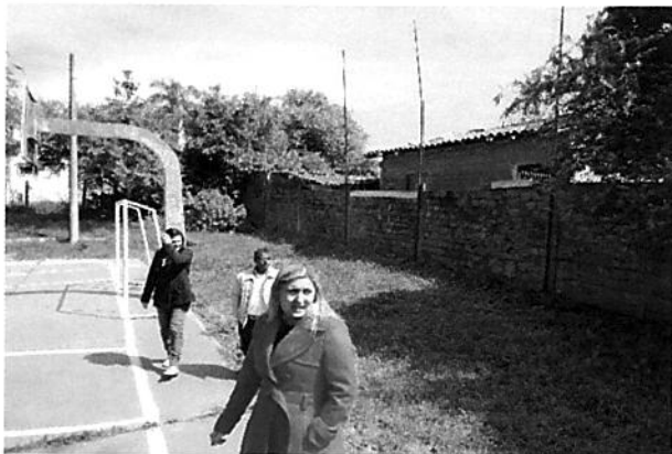
EEEB Padre Rômulo Zanchi – Cerca danificada junto à cancha de esportes.
