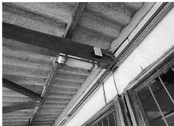
EEEB Padre Rômulo Zanchi – Iluminação de emergência danificada.
