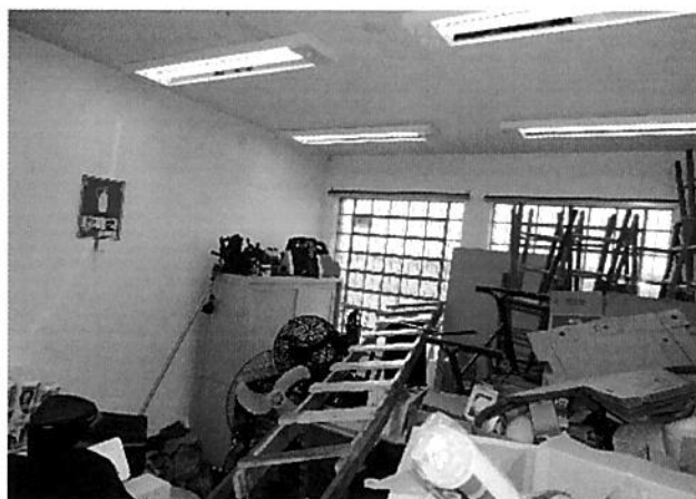
Escola Estadual de Ensino Médio Dr. Amílcar Gigante, ausência de extintores de incêndio.
