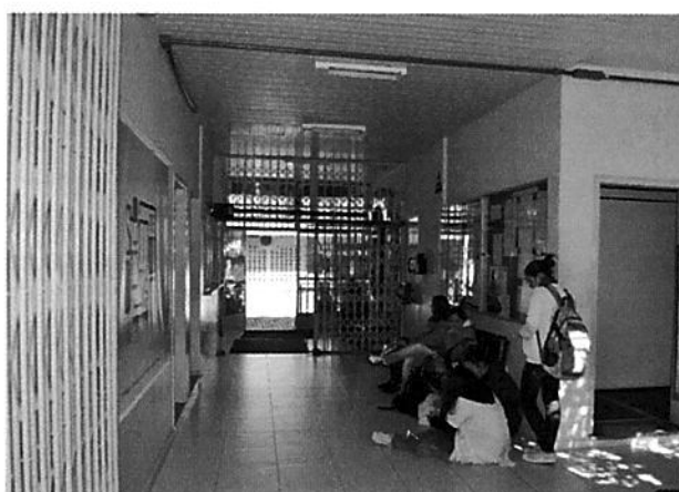
Escola Técnica Estadual Monteiro Lobato – Caixa de abrigo do extintor de incêndio sem a cor de sinalização.
