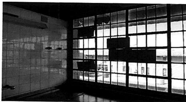
CIEP Santo Antônio – Lajeado – Vidros quebrados
