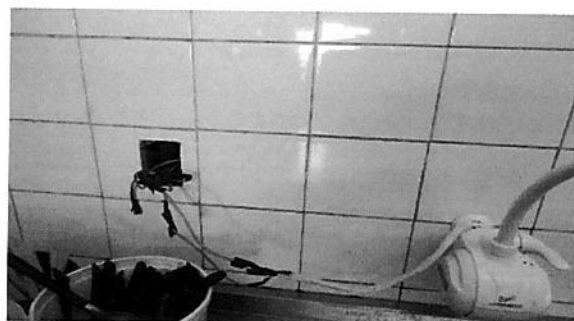
CIEP Santo Antônio – Lajeado – Instalação elétrica improvisada
