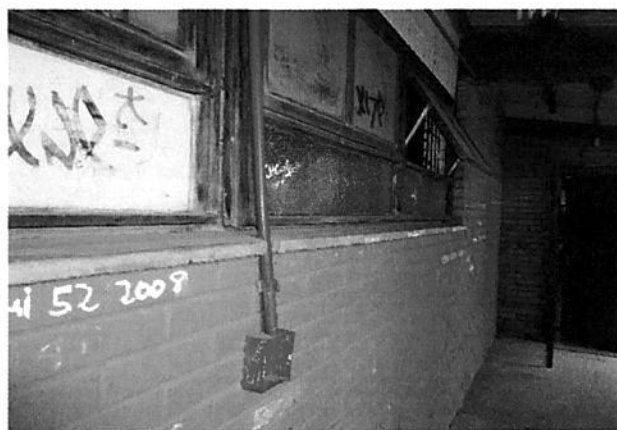
EEEB Padre Rômulo Zanchi – Sistema de alarme de incêndio danificado.
