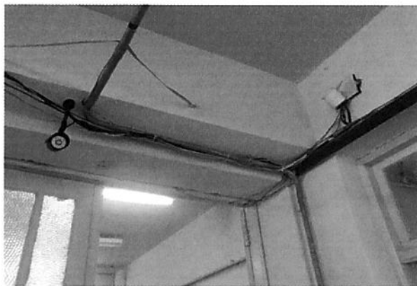
EEEB Padre Benjamim Copetti – Instalações de câmeras de segurança improvisadas
